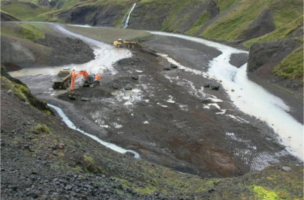
Efni var mokað ofan af lífrænum jarðvegi að þeim stað þar sem talið var að brekkurætur hafi verið áður en framkvæmdir hófust. Efni úr plani var að hluta til notað til að móta flatari brekku ofan við planið. (19.09.2009)
