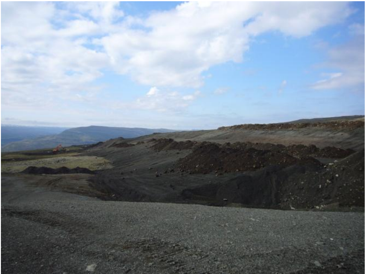
Lokið við af flytja jarðveg upp á frambrún haugsins. Við mótun haugsins var lögð áhersla á að form hans líktist sem mest landformum í næsta nágrenni. (26.06.2009)
