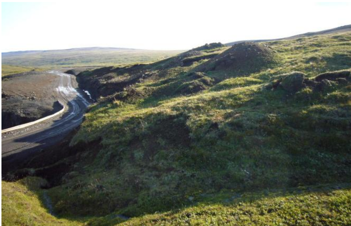
Vegskering ofan gangnamunna. Þessi skering var tekin í þykkan moldarkenndan jarðveg. Þarna var talsvert úrrennsli. Nauðsynlegt var að móta skeringuna að nýju til að tryggja uppgræðslu og að skeringin hefði sem líkasta löggun og halla og óraskað land. (20.08.2009)
