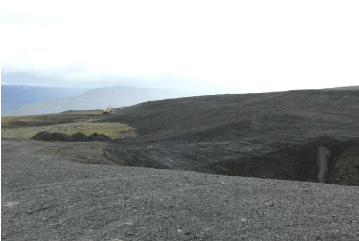
Nánast lokið við að ýta jarðvegi yfir frambrún haugsins. Lögð var áhersla á að dreifa grjóti um yfirborð hans í líkingu við grjótdreifar sem sjá má á öröskuðu landi nærri haugsvæðinu.(18.06.2009)
