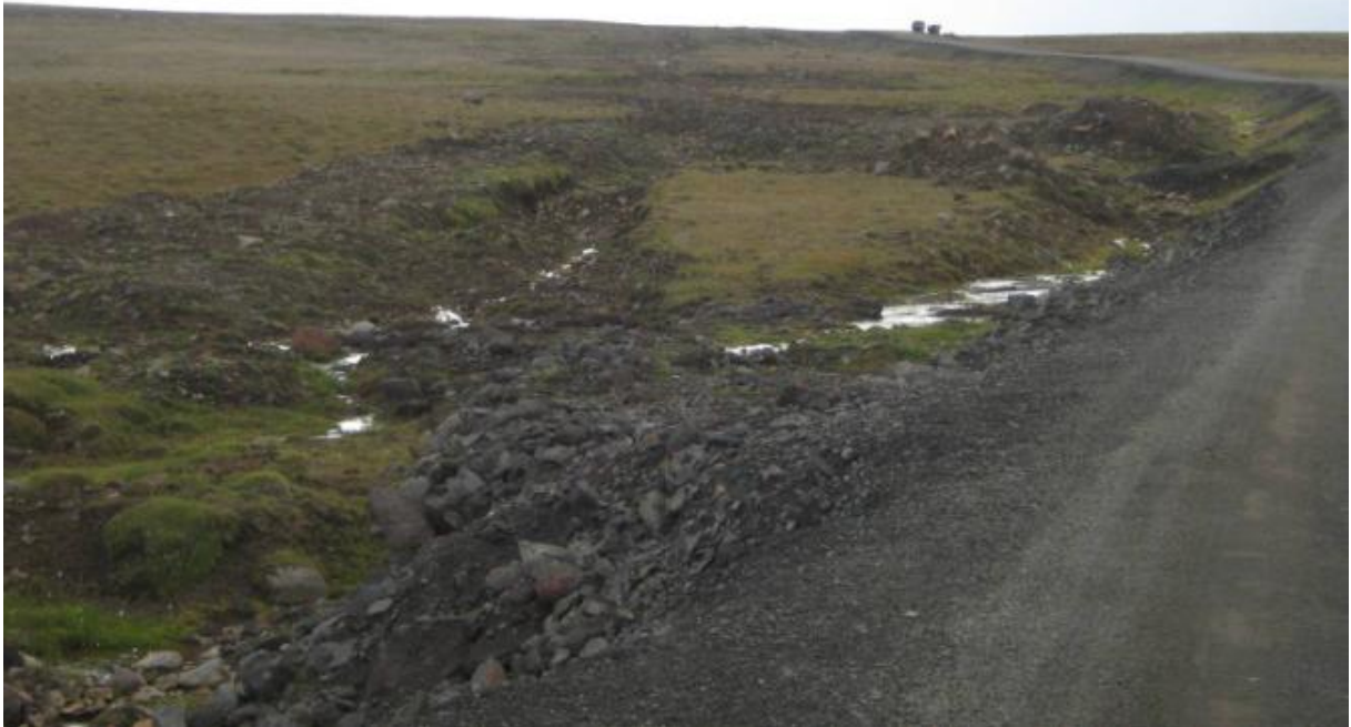
Aðkomuvegur í austan Garðavatns. Þarna er land mjög blautt og talsvert úrrennsli vegna vatnslagnar sem lögð var í skurði frá borholum við Garðavatn að athafnarsvæðum verktaka. (22.03.2011)
