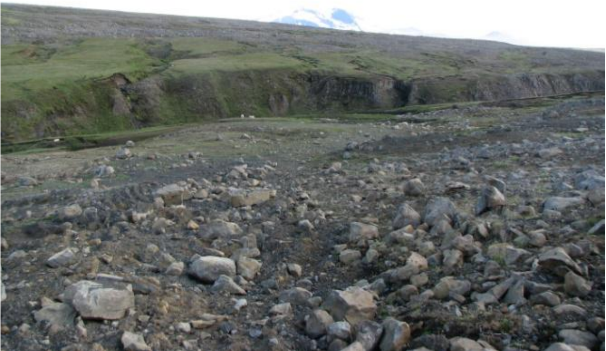
Plan var mótað í líkingu við næsta nágrenni og moldakenndum jarðvegi jafnað yfir. Vegur var rifinn upp til þess að fá grófara efni upp á yfirborð til þess að vegstæði líktist urðinni sem vegurinn var upphaflega lagður í gegnum. Grasfræi var sáð í röskuð svæði. (05.08.2010)
