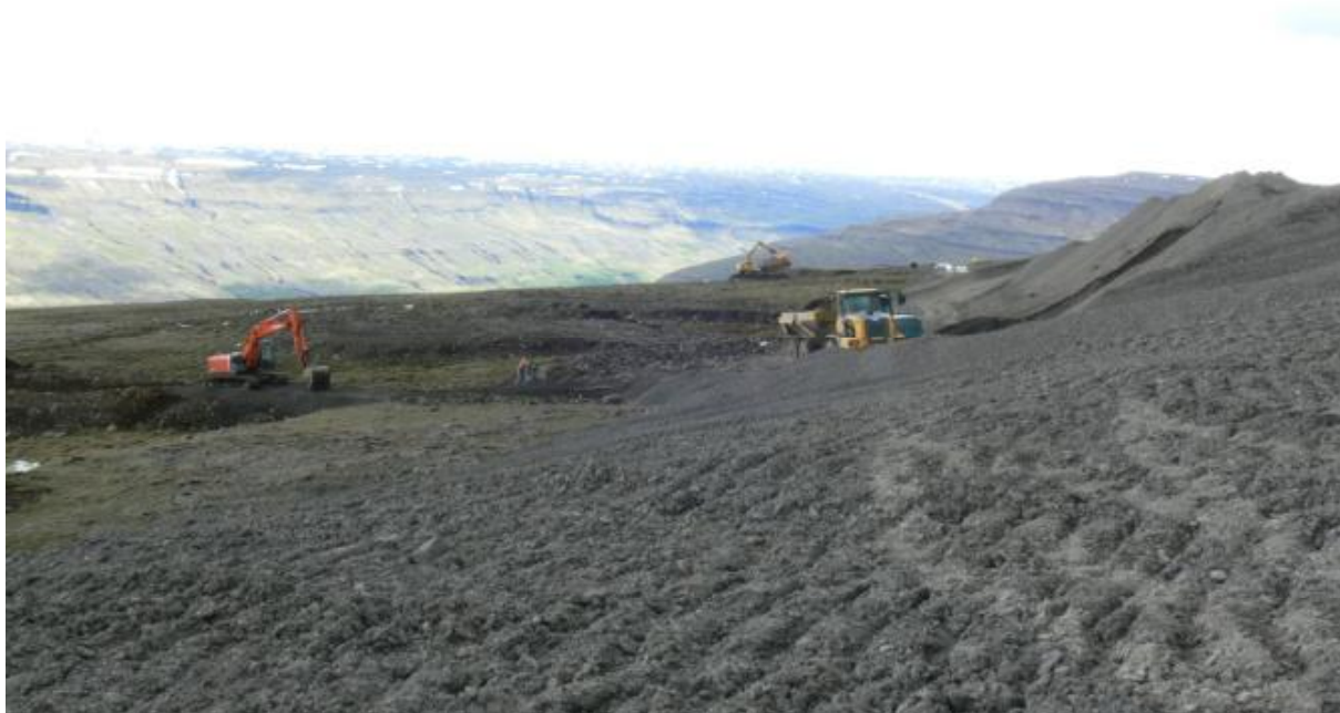
Jarðvegur var fjarlægður af haugsvæði við upphaf framkvæmda og geymdur til frágangs að framkvæmdum loknum. Þegar móttun haugsins var lokið var jarðvegur fluttur upp á haugsvæðið. (21.06.2009)
