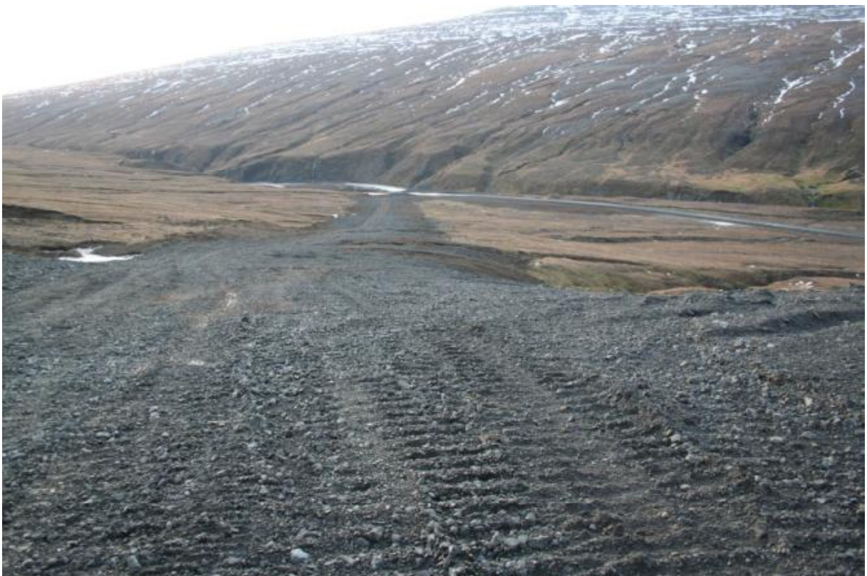
Færibandaslóð þegar steiptar undirstöður hafa verið fjarlægðar sem og hluti efnis úr slóðinni. (07.10.2004)
