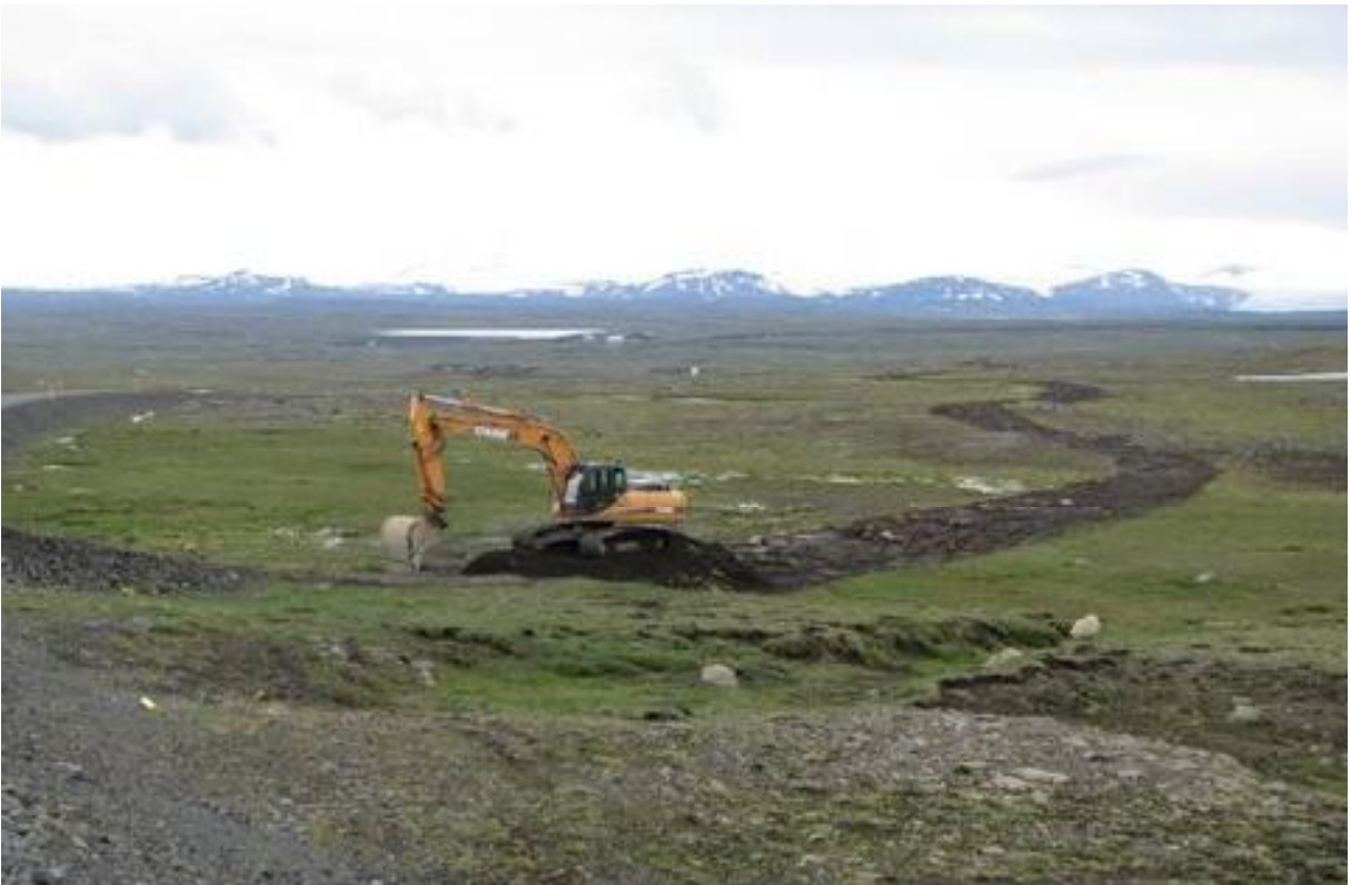
Aflagður vegur nærri Hafursá. Gengið var frá námu með efni úr veginum. Fyrirhugað er að bera tilbúinn áburð á vegsvæði til að flýta gróðurframvindu.
