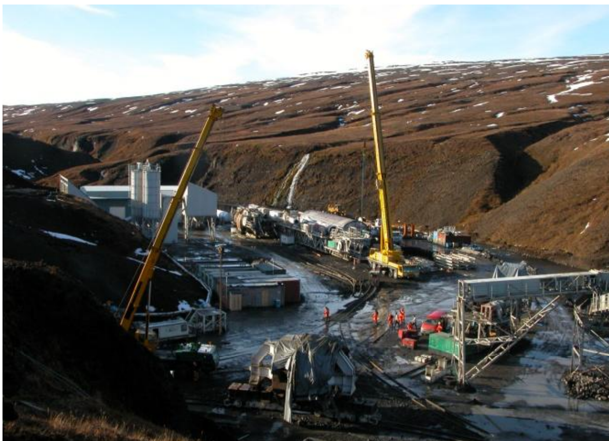
Borun jarðganga lokið. Byrjað er að taka niður færiband. Búið er að taka jarðgangabor í sundur og flytja hann út úr göngunum. Hluti plans var steypur til að bera þung tæki eins og borinn. (10. 2005)
