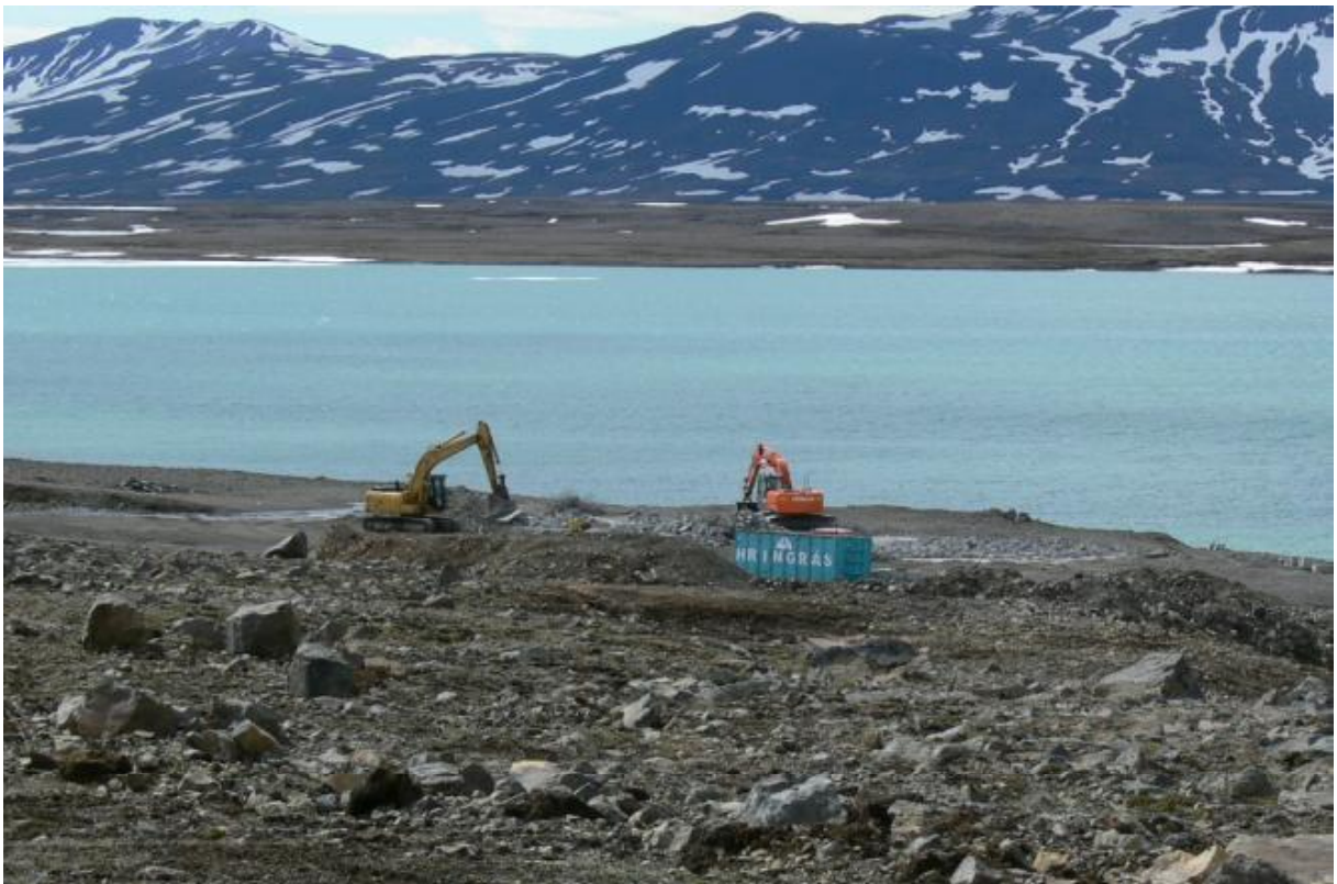
Búið að fjarlægja byggingar. Steypar plötur voru brotnar, steypustyrktarjárn var fjarlægt til endurvinnslu og steypubrot urðuð í námu skammt sunnan verkstæðis. Vegur frá verkstæði að aðkomuvegi var fjarlægður og efnið úr honum notað til urðunar á steypu. (10.06.2010)
